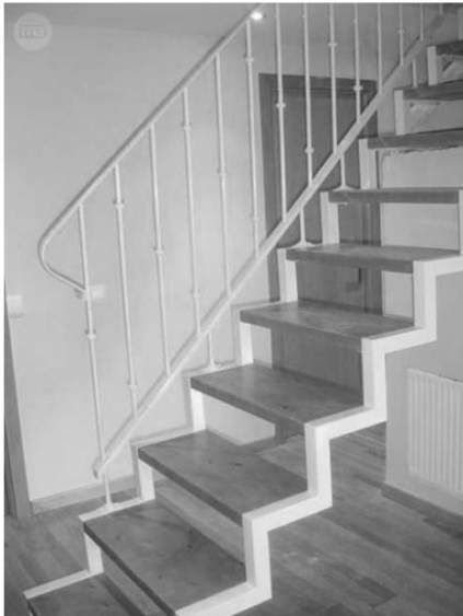
Escalera con zanca doble
