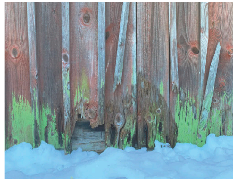
Roiskeista kärsiyt julkisivu.
